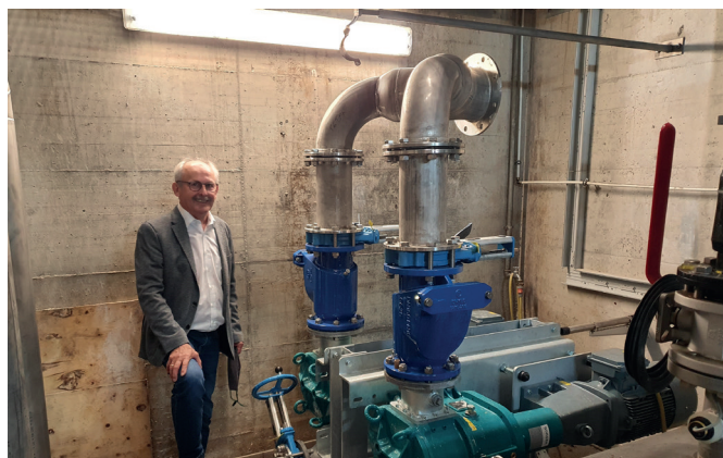
Bürgermeister Harald Bemmerl machte sich selbst ein Bild von den zwei neuen Drehkolbenpumpen. Sie machen die Steinberger Abwasserentsorgung effizienter, ausfallsicherer und leiser. Foto: Michael Weiß/IVG Wackersdorf-Steinberg am See
