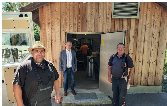
Abwasserwart Thomas Knerer, Bürgermeister Harald Bemmerl und Bauhofleiter Rupert Binner besuchten die Baustelle im Abwasser-Pumpwerk. Im Hintergrund laufen die abschließenden Installationsarbeiten der neuen Pumpe. Foto: Michael Weiß/IVG Wackersdorf-Steinberg am See
